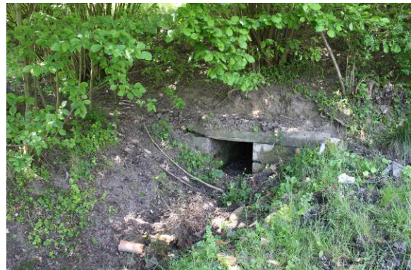
Blick von unterhalb auf den Durchlass zum Entwässerungsgraben. Auch hier befinden sich zahlreiche Hasel-Sträucher.
